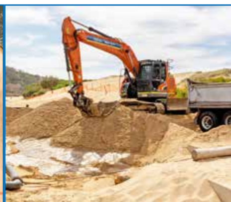
Une excavatrice dépose le sable dans des camions pour être transporté vers les plages voisines.
