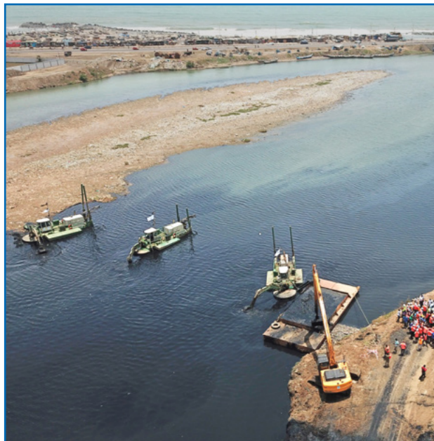
RESTABLECER LAS DESEMBOCADURAS SEDIMENTADAS DE LOS RÍOS PARA EVITAR INUNDACIONES
